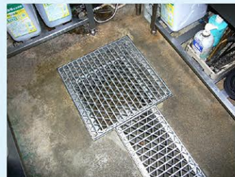
厨房（スチール）
