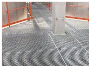
37.プラント施設
