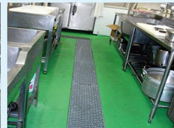
厨房（スチール）
