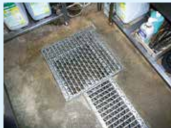
厨房（スチール）
