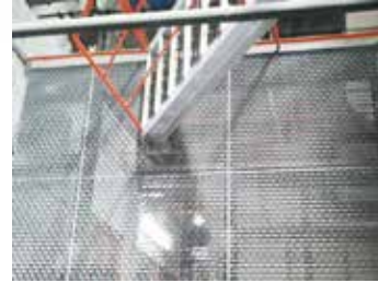
38.プラント施設
