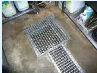
厨房（スチール）
