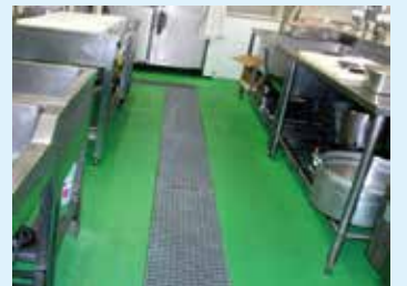
厨房（スチール）
