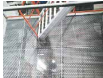
38.プラント施設
