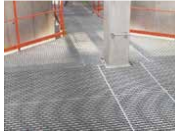
37.プラント施設
